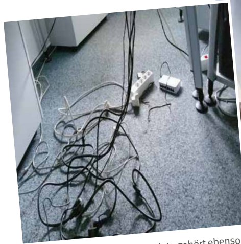
Die Behebung solcher Kabelsalate gehört ebenso dazu wie die Reinigung von Schränken.
